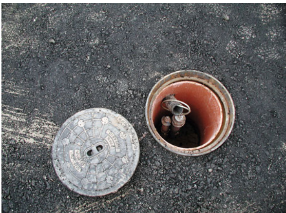
Bild 4. Beispiel eines mittels Spezialschacht in der Straßenoberfläche eingebauten WLM-Sensors.
